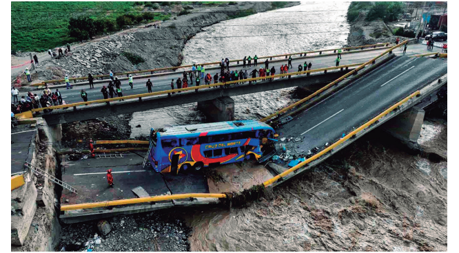
Puente en la ruta a Chancay que se cayó recientemente, una prueba de lo deficiente que es la conectividad en el Perú
